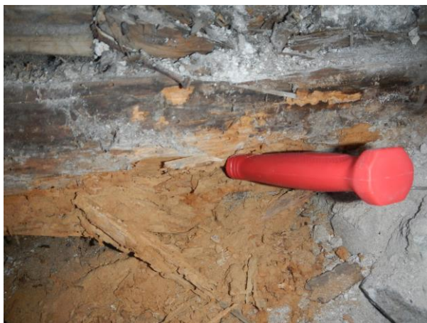
Bild 5 visar detalj röt/insektsskador bottenstock.
