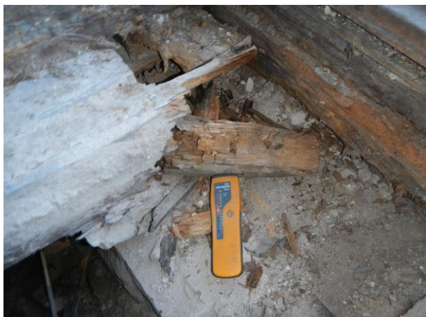
Bild 4 visar röt/insektsskador bottenstock hall, 22 % FK.
