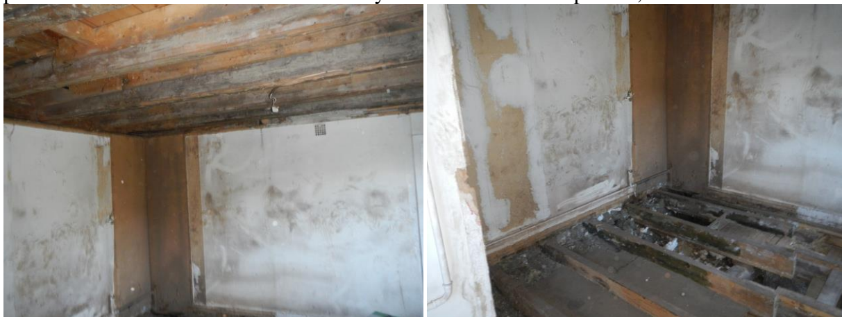
Bild 10 och 11 visar området kring avloppsläckaget i vardagsrummet.
