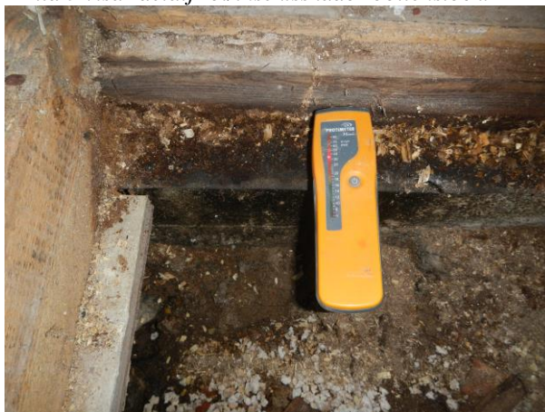
Bild 7 visar fritt vatten vid bottenstock, 50 % FK.
