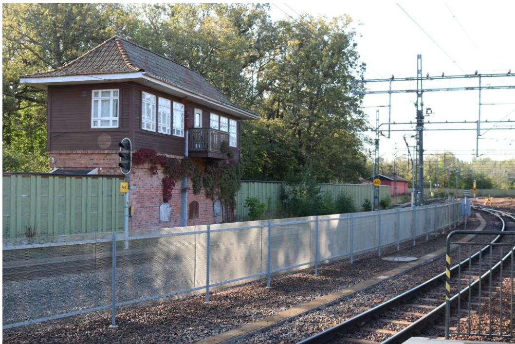
Figur 4 Ställverket vid Djursholms Ösby station längs Roslagsbanan.
