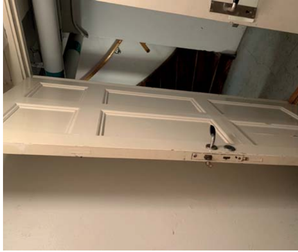
Skolan 12. Dörrblad i källaren som sannolikt är flyttat från en äldre byggnad, kanske den ursprungliga skolbyggnaden från 1907.
