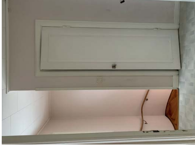
Skolan 11. Dörr till WC med beslag är intakt.
