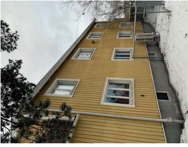
Skolan 11. Fönster ligger insjunkna i fasaden sedan de tillägsisolerades på 1980-talet.
