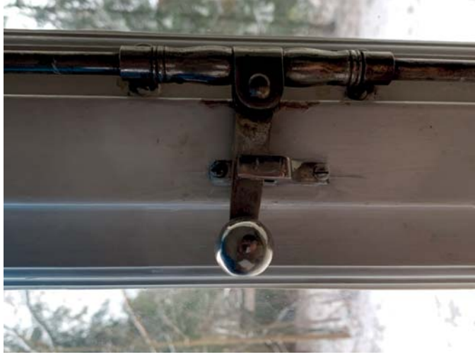
Skolan 11. Fönster med sparjletter.
