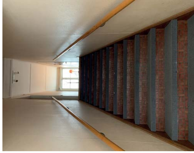
Skolan 12. Trappa till övre lägenheter. Ursprunglig trappa med sekundära ytskikt. Ursprungliga handledare, innertak och fönster.
