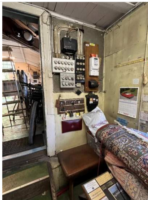
Elcentraler och proppskåp i kontor.
