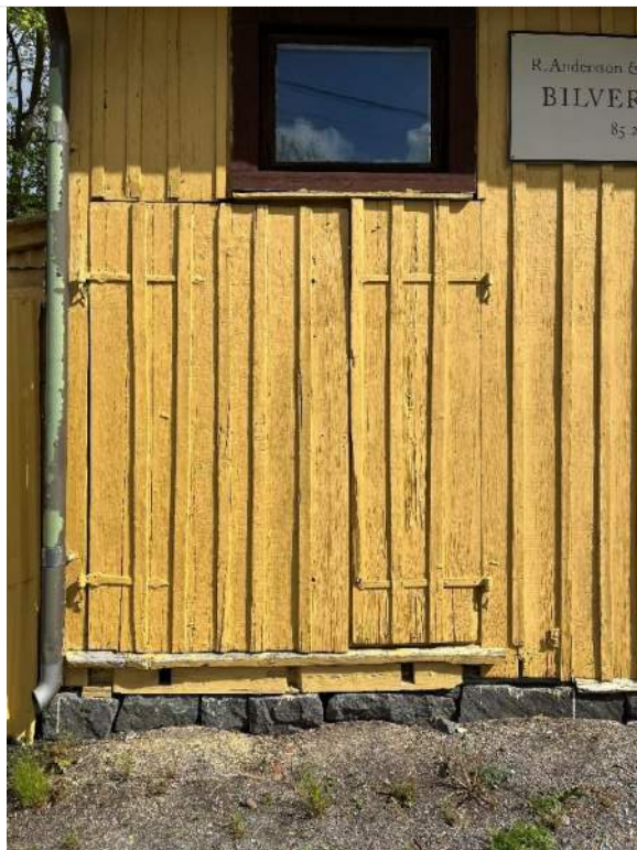
Fasad mot söder, västra delen. Igensatta äldre ytterportar.
