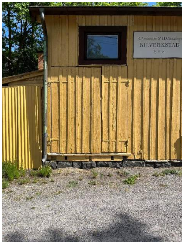
Fasad mot söder. Fönster mot lager ovan igensatt dörr.
