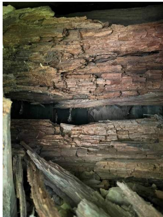
Detaljbild av rötskadat timmer.
