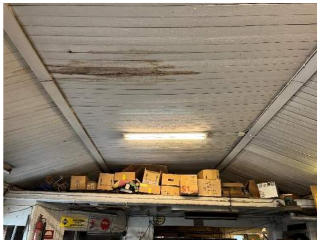
Innertaket i verkstaden fuktskadat efter takläckage.
