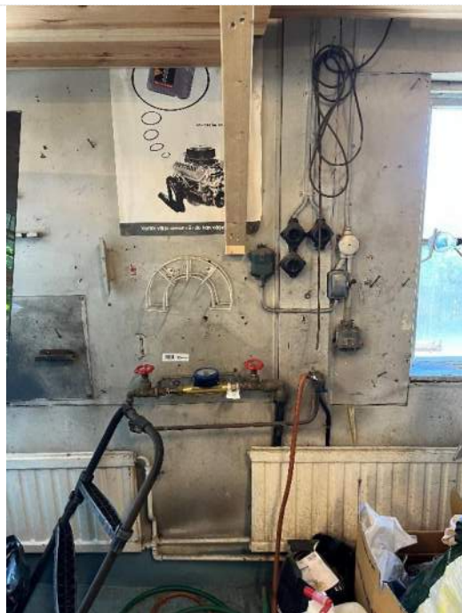
Inkommande vatten och elinstallationer i verkstadsdelen, vägg mot söder.
