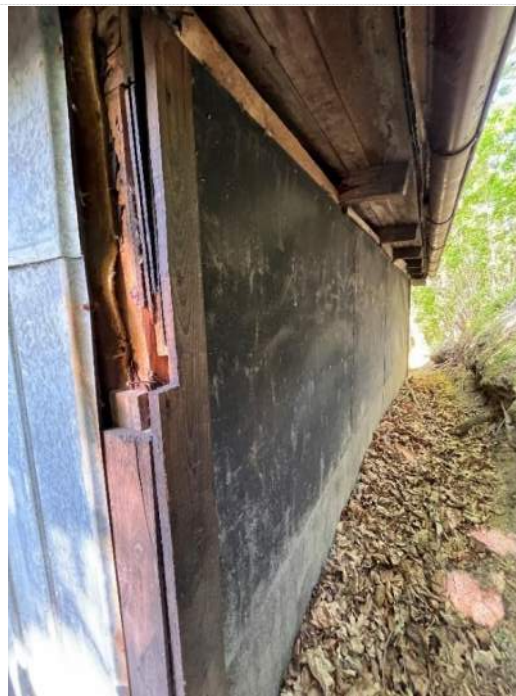
Norra fasaden på 1940-talets tillbyggnad. Likartade problem med förhöjd marknivå och fukt.
