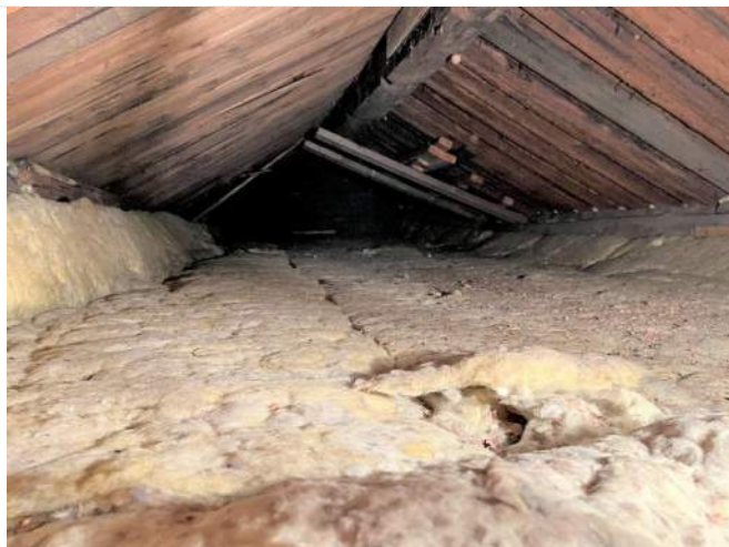
Yttertaket uppstöttas med brädor. Troligen skadat efter takläckage.
