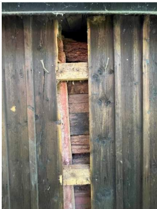
Norra fasaden, demonterad panelbräda. Omfattande rötskador i timmerstomme och i äldre rödfärgad ytterpanel. Nyare locklistpanel ytterst.
