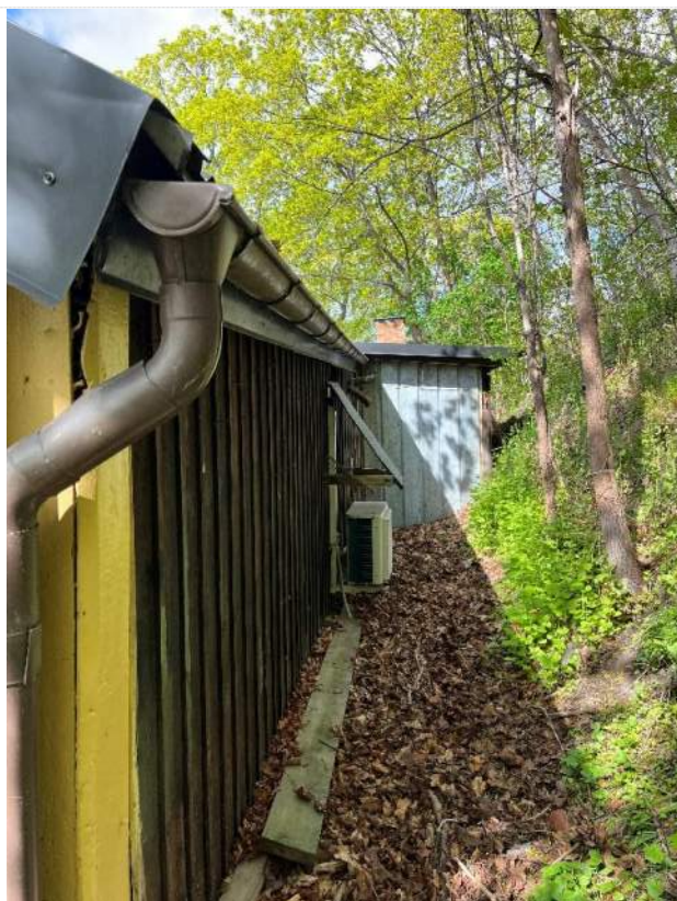
Fasad mot norr. Slänt mot byggnaden med förhöjd marknivå och bristfällig dränering skapar problem med fukt och röta i panel och timmerstomme.
