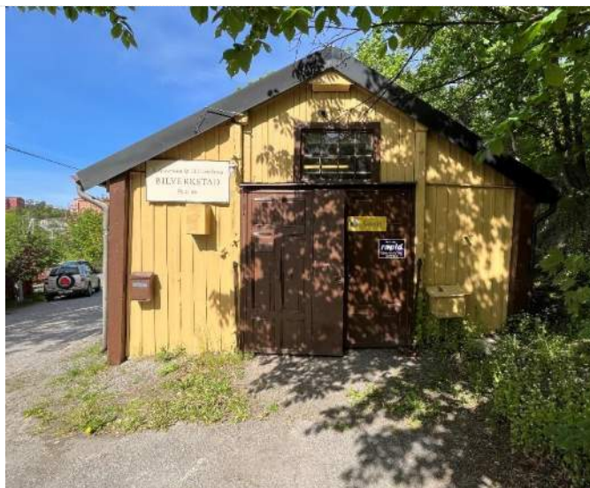
Fasad mot öster. Garageport bestående av två äldre dörrar med kompletterande mellandel.
