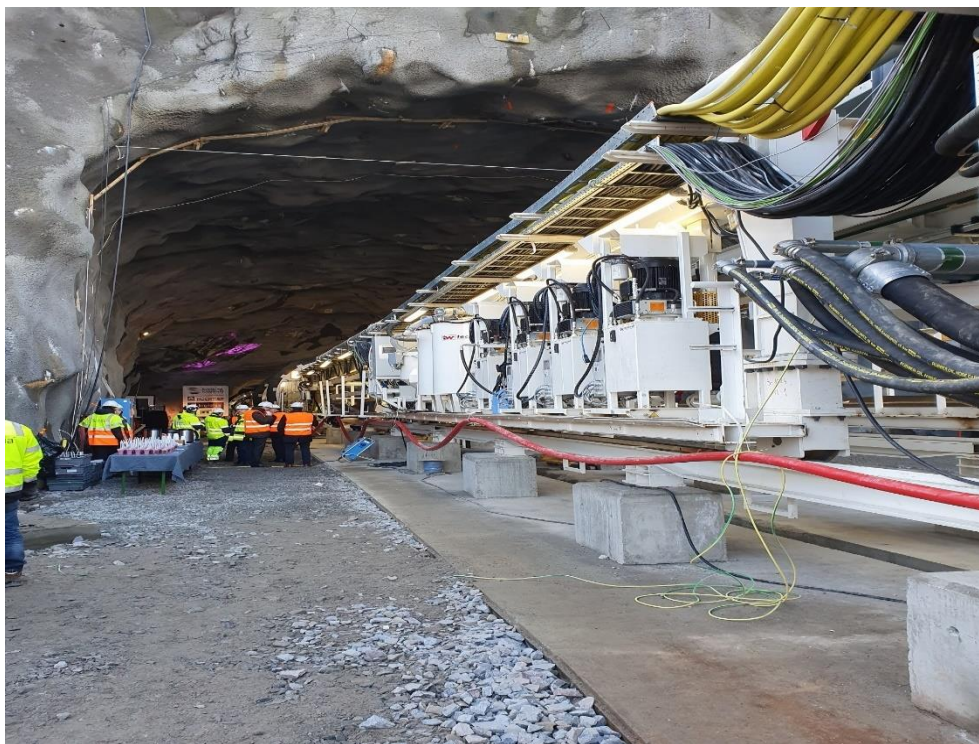
Bild ovan: Kraftledningstunnel.
