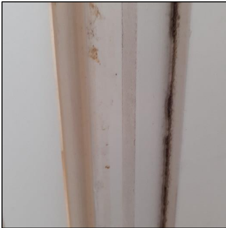
Figur 2 Svällist på dörr mot tvättstuga
