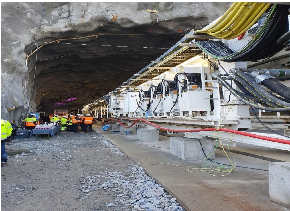
Bild ovan: Kraftledningstunnel.
