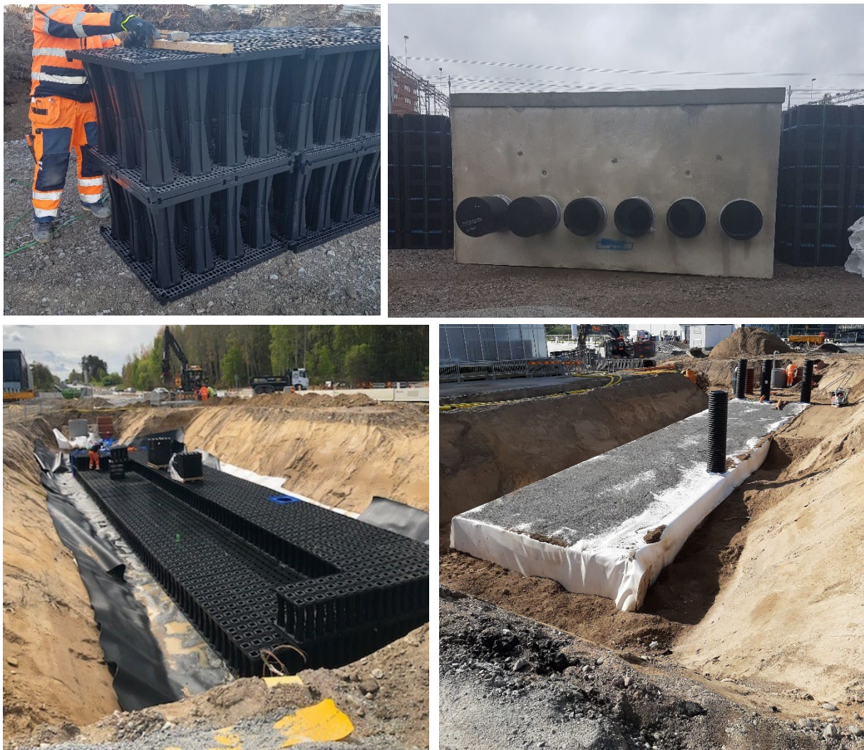
Figur 19. Underjordiska magasin som detta kassettmagasin i Järfälla (uppe) och Sollentuna (nere) kan användas i områden där ytor för anläggningar i marknivå saknas. (Foto: Bjerking).
