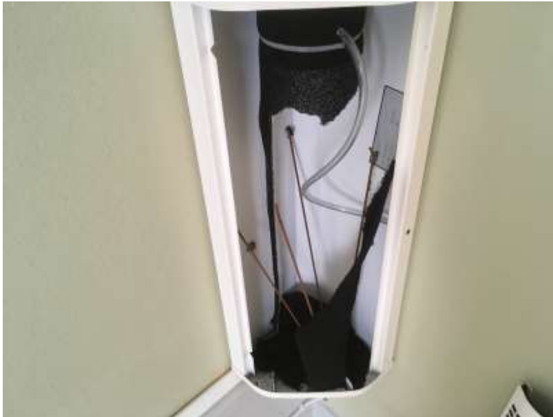
Bild 2 Tilluftsdon, invändig fördelningsmatta och strumpa har fallit isär.
