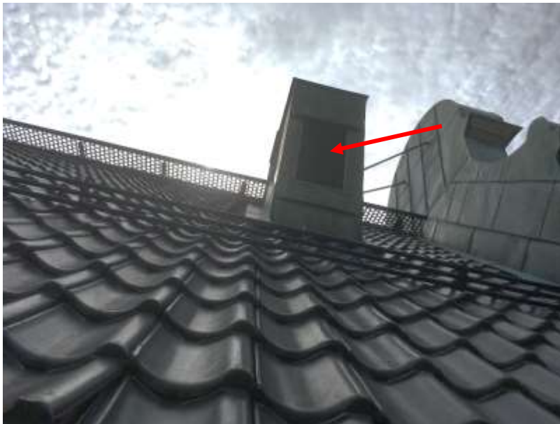
Bild 5 LB01, avluftsgaller. Luftintag på vänster sida.
