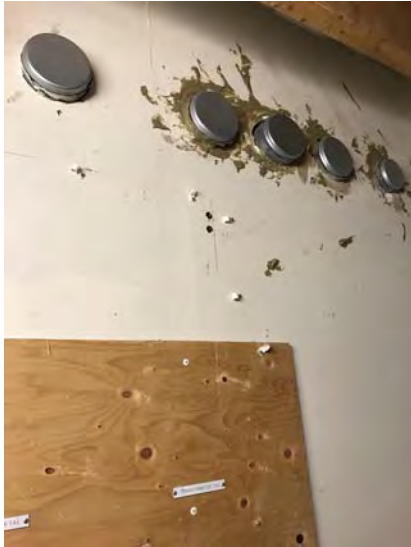
31. Proppade Kanaler i fläktrum.
