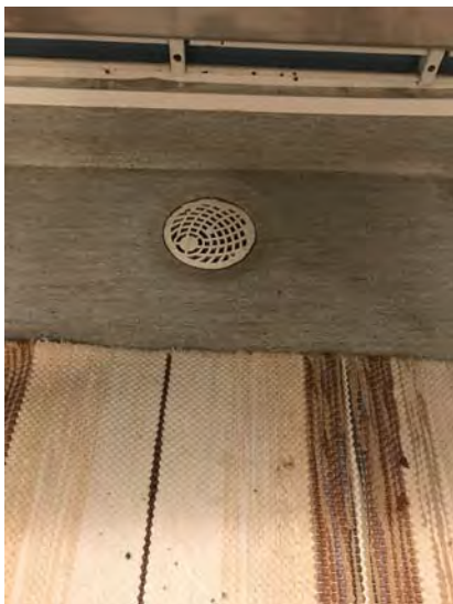
11. Golvbrunn vid tvätträna, tappställe saknas.
