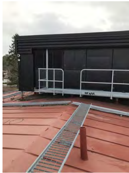
26. Kraftig nedsmutsning under LB01.
