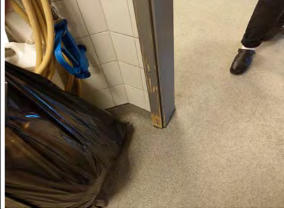
02. Fuktrelaterade skador på karm,foder.
