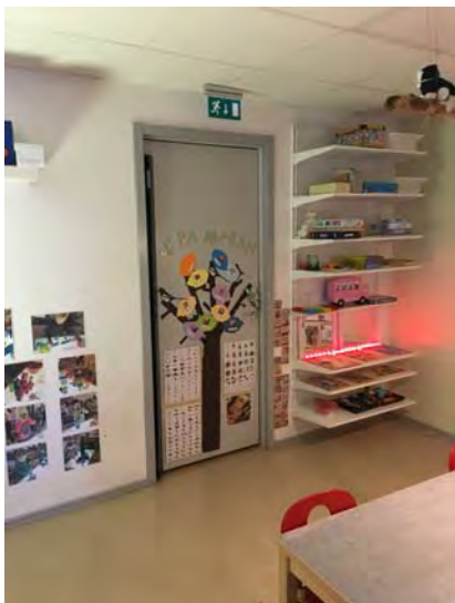
05. Nödbeslysning av vägledande markering bör kontrolleras. Dörr saknar möjlighet för återinträde.
