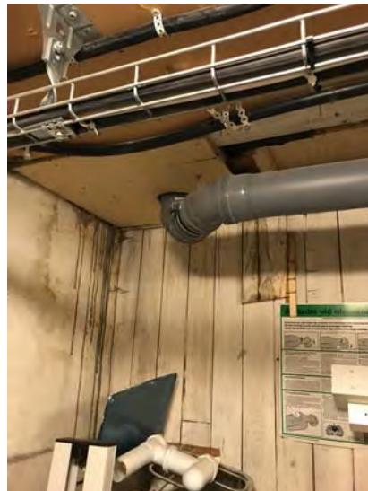
48. Spillvattenledning i elcentral, risk för vattenläckage.
