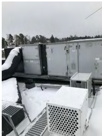
18. Till och frånluftsaggregat på yttentak.
