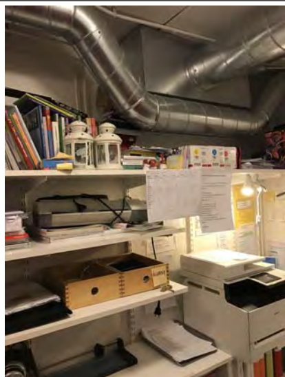
18. Ventininstallationer i korridor.
