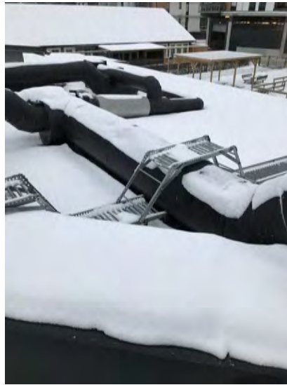
20. Yttertak med till- och frånluftskanaler.
