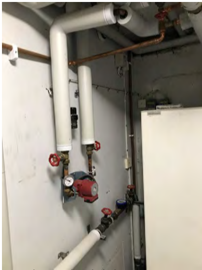
15. Skjutventiler+oisolerade ledningar i varmvattenberedning
