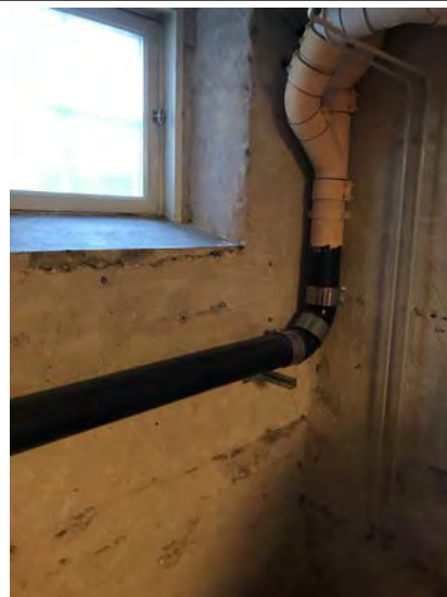
36. Spillvatteninstallation i källare.
