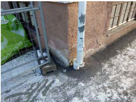
03. Skador på putsad sockel.
