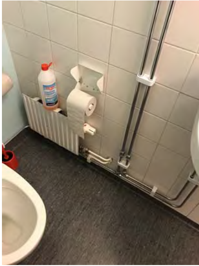
25. Kopplingsledning radiator i vägg.
