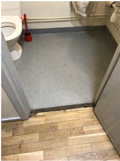
07. Fuktskada, bra nivåskillnad.
