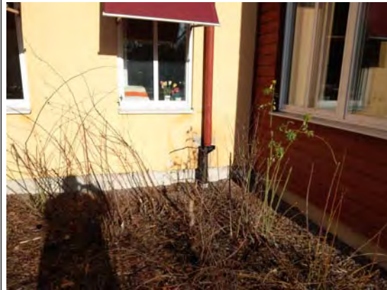
02. Vatten från stuprör.
