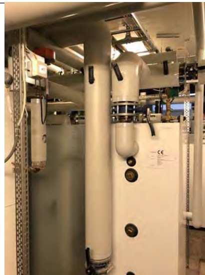
23. Del av bergvärmecentral.
