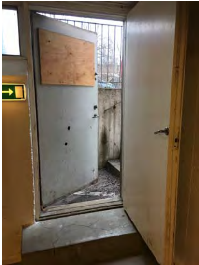
13. Dörrar svåröppnade samt högt sittande vred.
