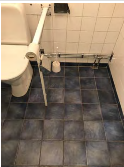
13. Genomföring i golv WC-rum.
