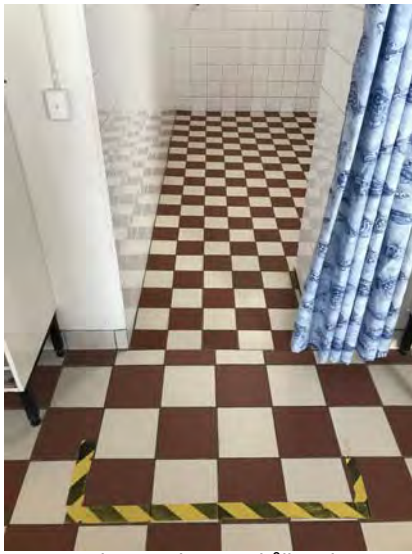
19. Dusch 1132, kan innehålla asbest.
