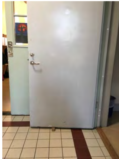
22. Dörrar i brandcellsgräns uppställda på kil.
