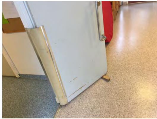
32. Branddörr uppställd på kil.
