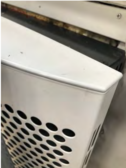
45. Uteluftsdon ej avtätat mot yttervägg.
