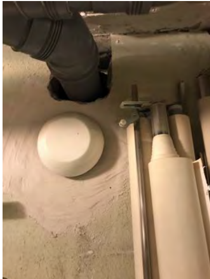
43. Brandtätning och brandstrypare saknas. Överluft genom brandcell.
