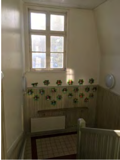
25. Fönster för brandgasventilation är ej åtkomliga för räddningstjänst.
