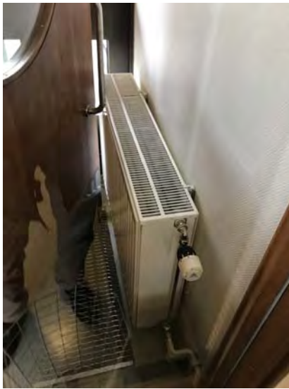
19. Ytterdörr slår i radiatorentre.
