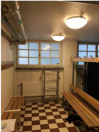
31. Vägledande markering för fönster utrymning saknas.
