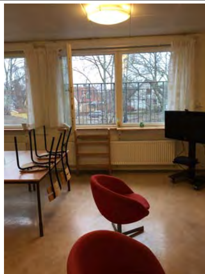
18. Vägledande markering saknas ovan fönster för utrymning.
