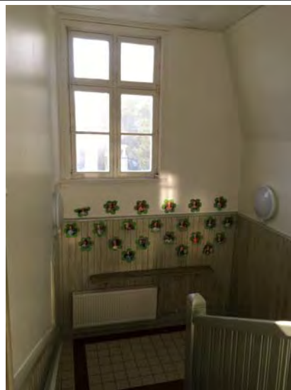
24. Ej möjlighet för räddningstjänst att öppna fönster för brandgasventilation.
