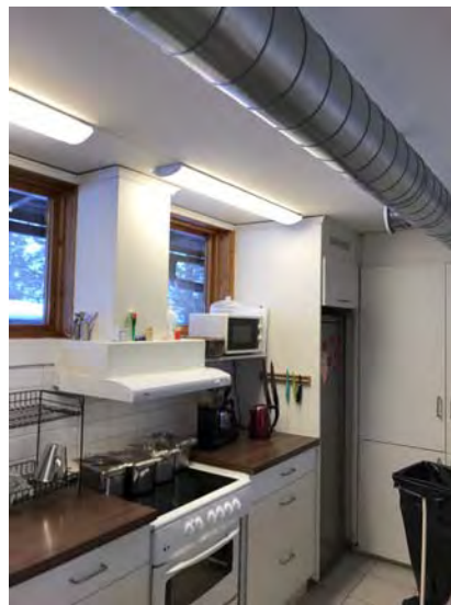
20. Kök med synlig kanal.
