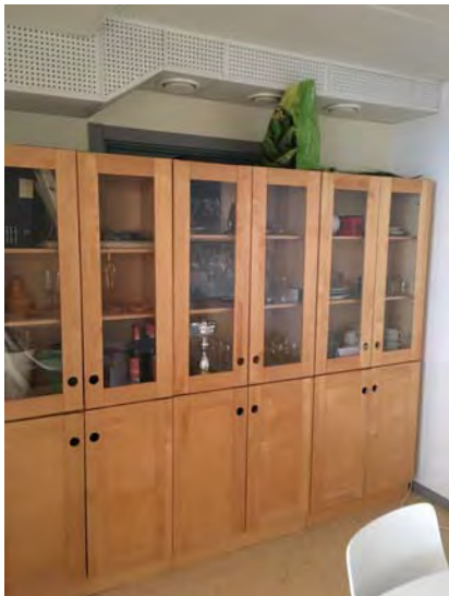
15. Garderob blockerar dörr som ska användas för utrymning
