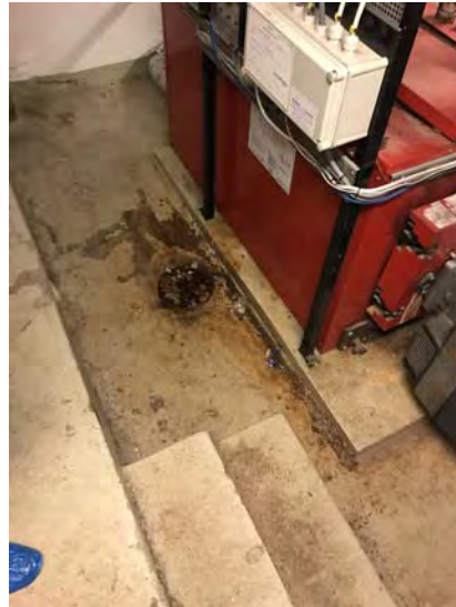
38. Golvbrunn i undercentral.
