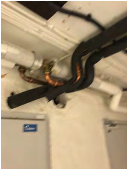
41. Bristfällig isolering köldbärare.
