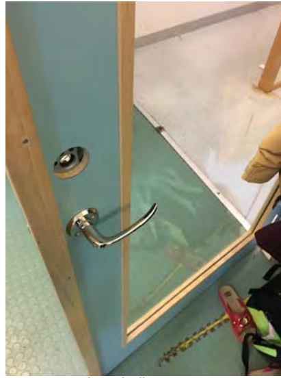
08. Dörr i brandcellsgräns är ej tät.
