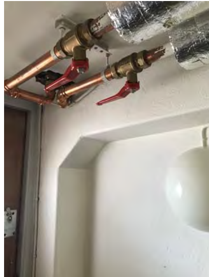
40. Bristfällig isolering på rörledningar i källare.
