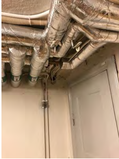
37. Värme och vattenledningar i källare. Brandtätningar saknas.
