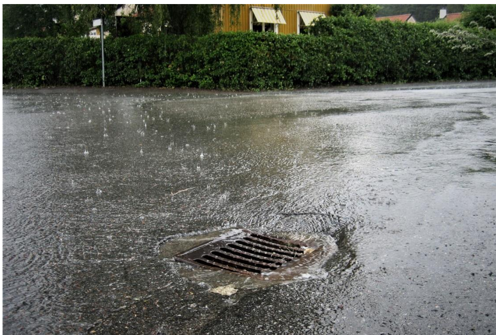
Bild ovan: Regnvatten i dagvattenbrunn.
