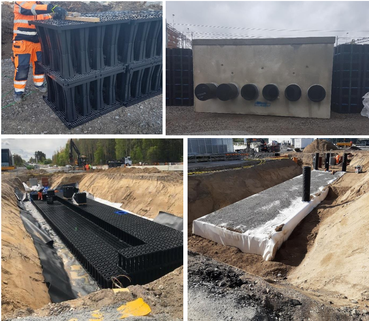
Figur 19. Underjordiska magasin som detta kassettmagasin i Järfälla (uppe) och Sollentuna (nere) kan användas i områden där ytor för anläggningar i marknivå saknas. (Foto: Bjerking).
