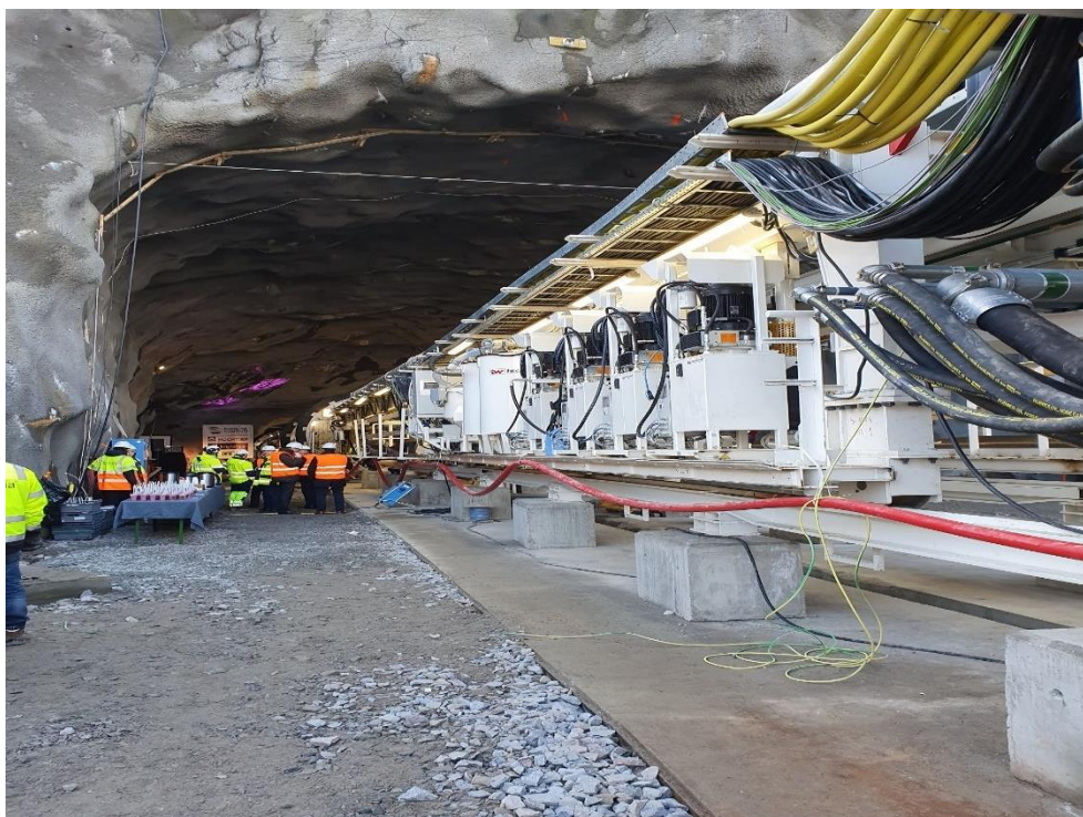
Bild ovan: Kraftledningstunnel.
