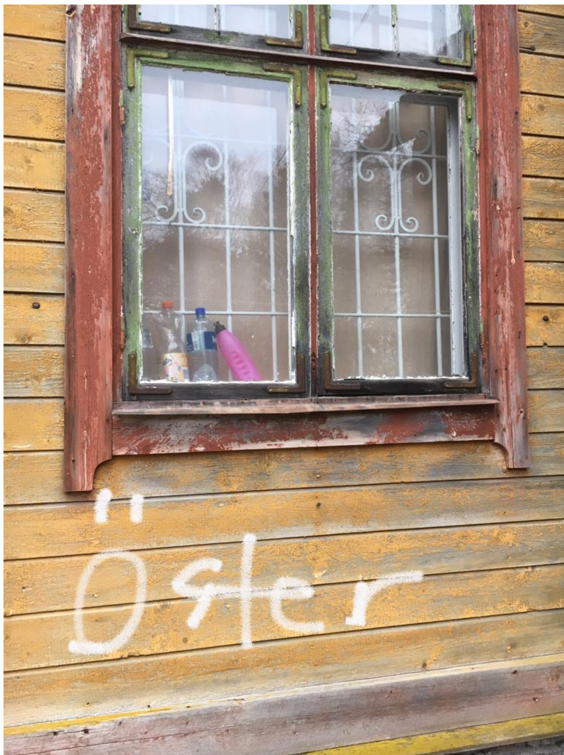
Östra fasaden – sättningar kilar fast fönster, allmänt dåligt skick fönster
