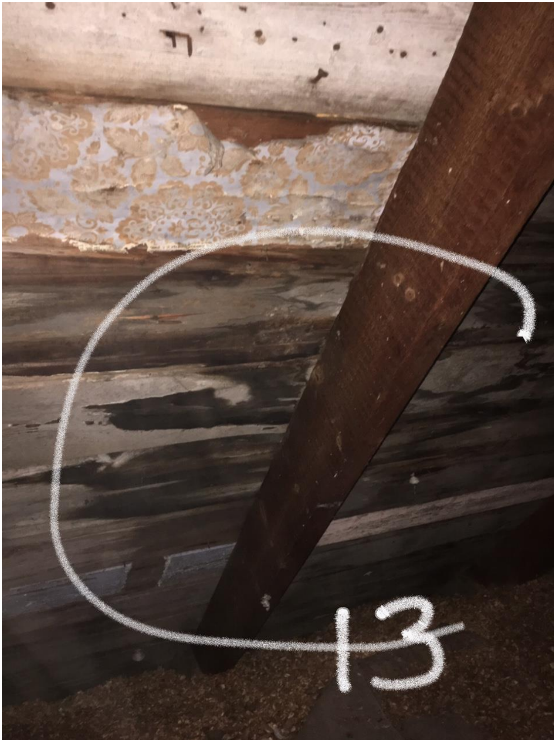
Fuktgenomslag i yttertak östra sidan, mitt för skorsten. Motsvarande skada i innertak i våningen under. Fuktigt spån, fuktig matta eller liknande textil under skadan (13)
