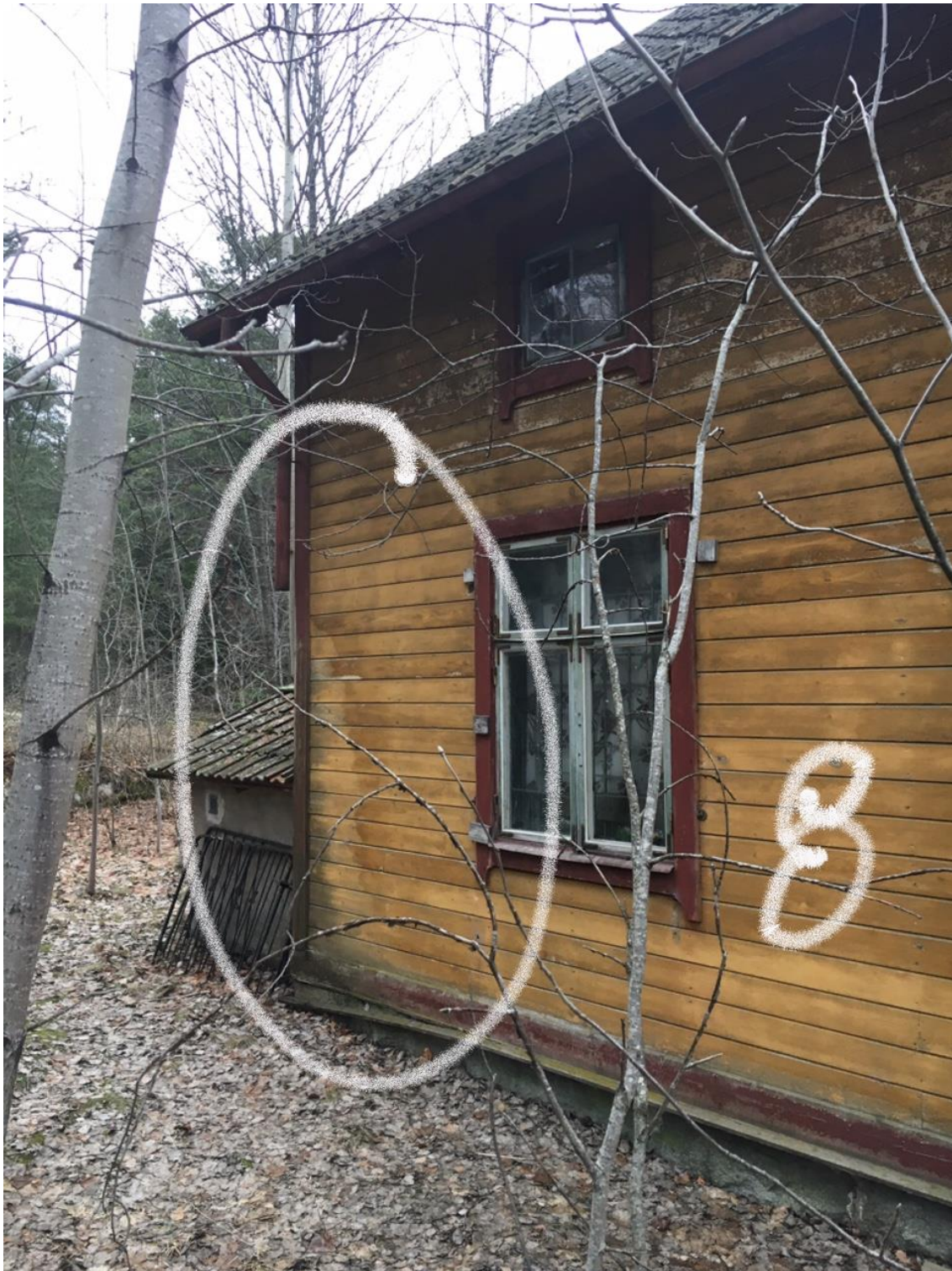
Stuprör saknas i nordväst, skadad fasad (8)
