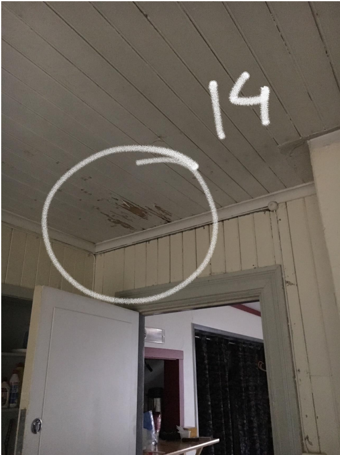
Övervåningens kök, fuktgenomslag under skada nr 13 på vind (14)
