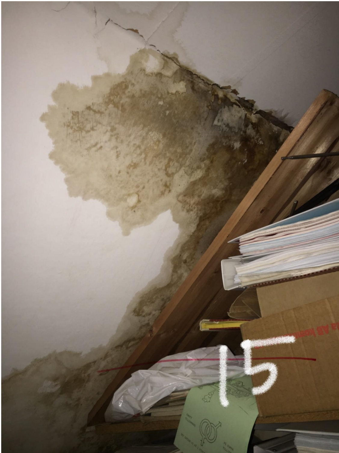
Övervåningens rum, mot sydöstra hörnet, skada snett under nr 12 på vinden (15)
