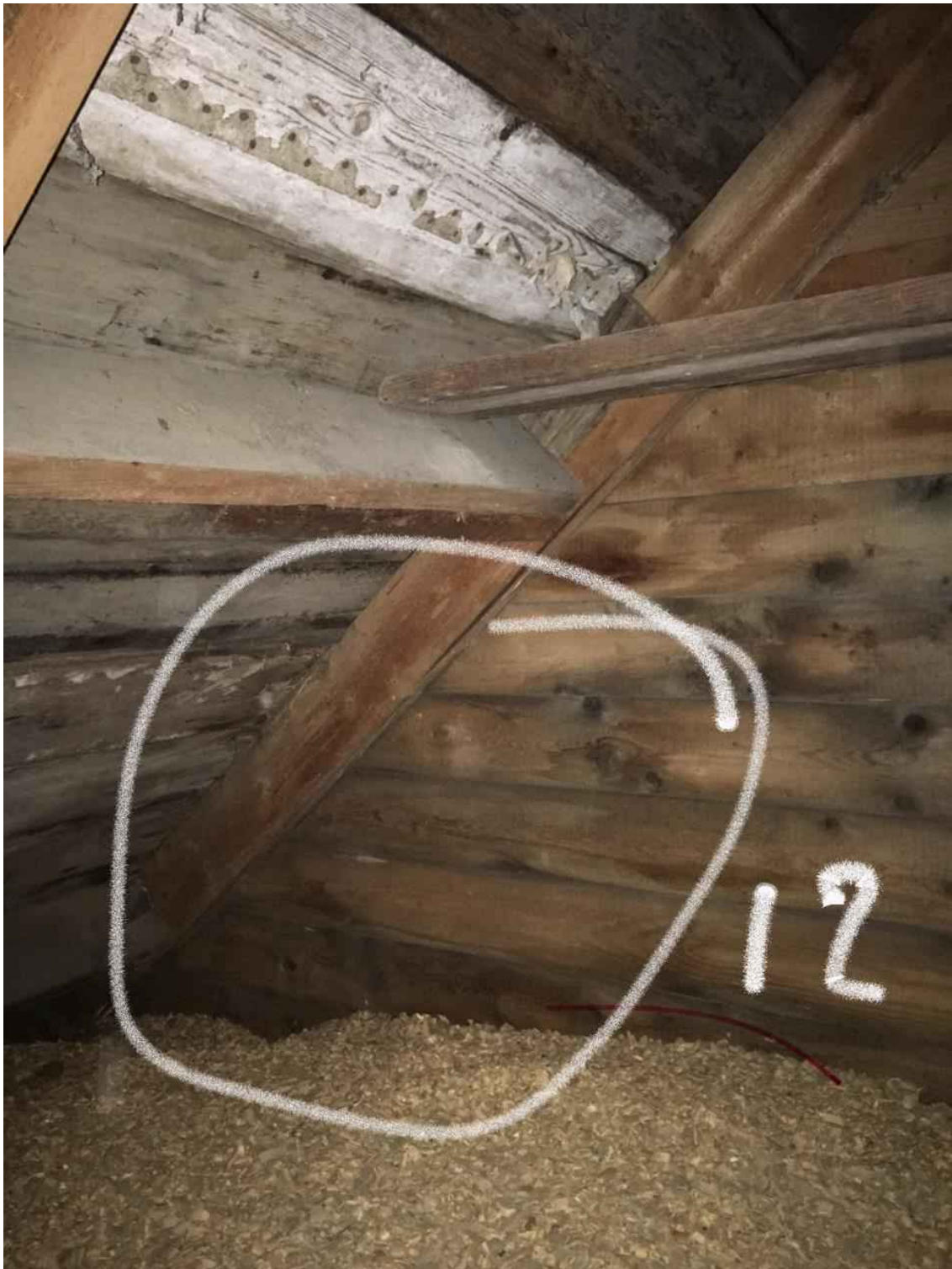
Fuktskada på vind ovanför fuktskada nr 15 i sidorum övervåning (12)
