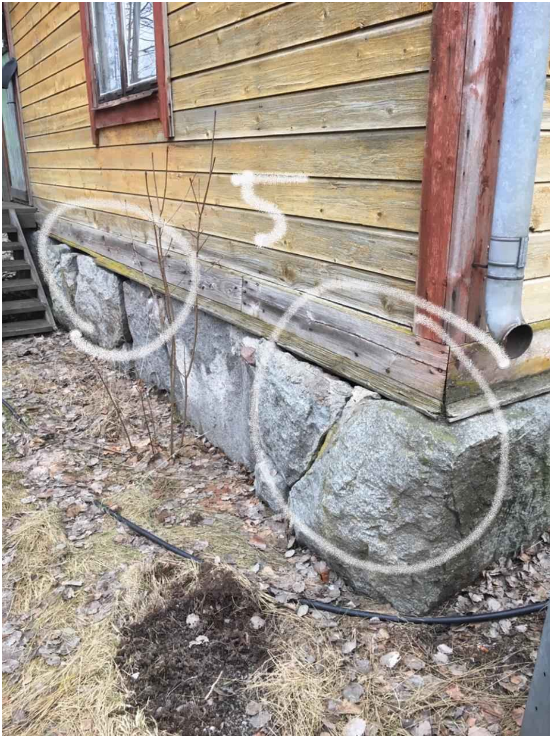
Sättningar, sten rör sig utåt, skador på panel (5)
