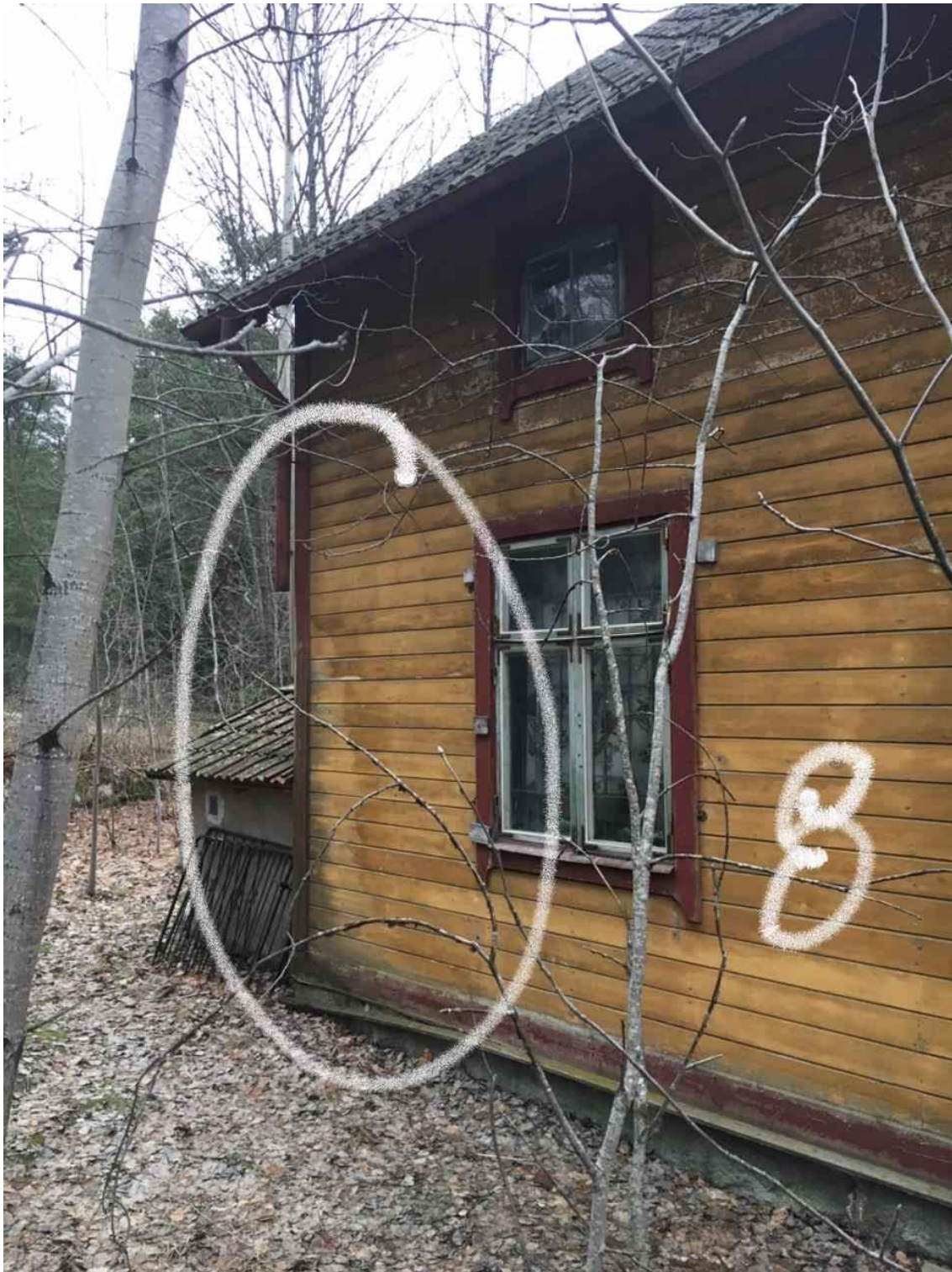
Stuprör saknas i nordväst, skadad fasad (8)
