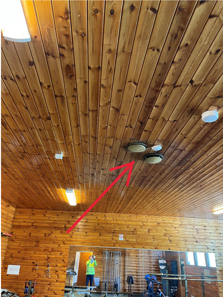
Ej kontrollerade vent.kanaler ovan fasta undertak. Kontrolleras vid rivning
