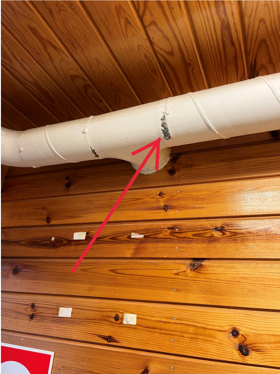
P1: Asbest i vitmålad tätmassa utvändigt på spirokanaler
