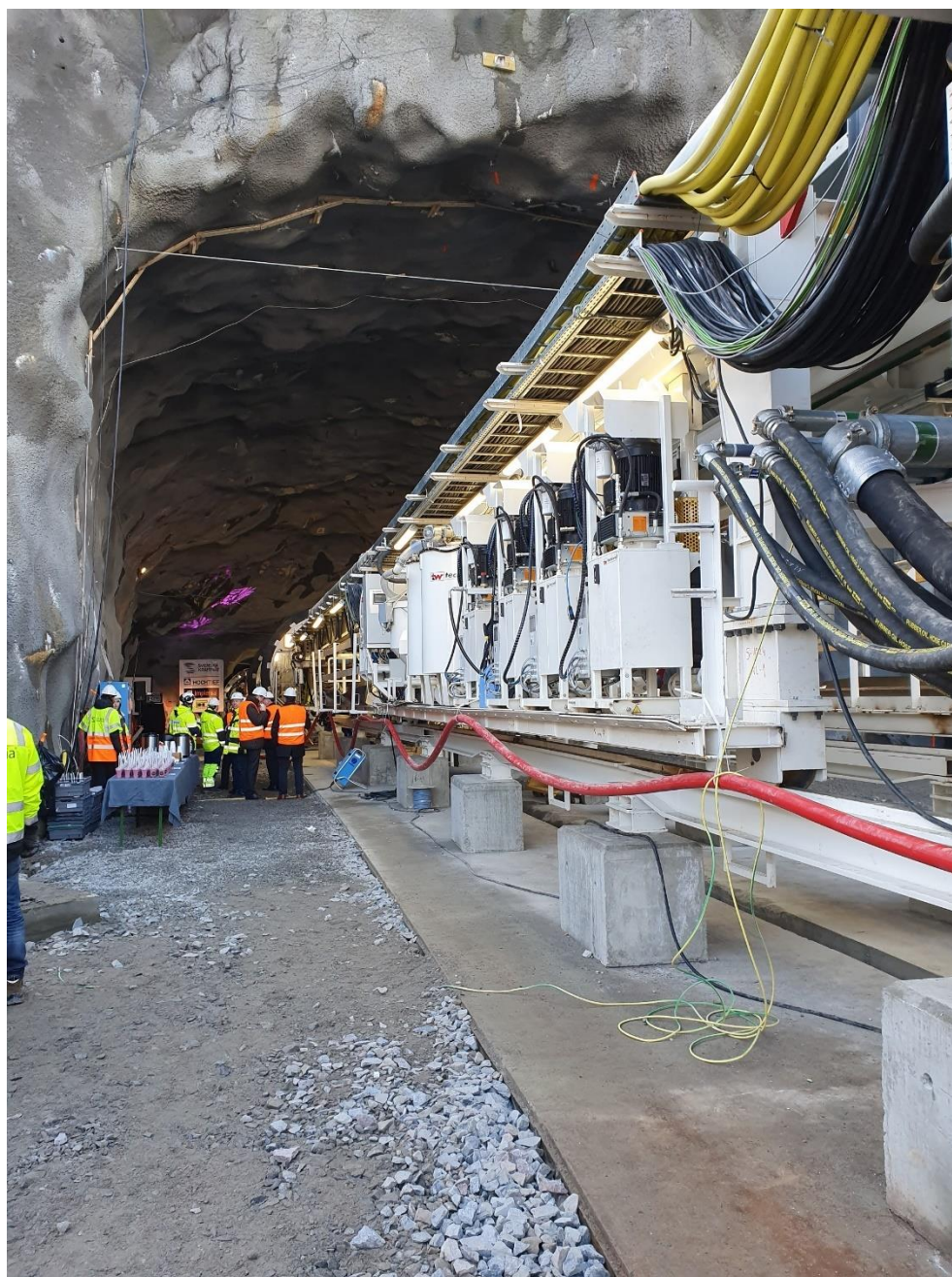
Bild ovan: Kraftledningstunnel.
