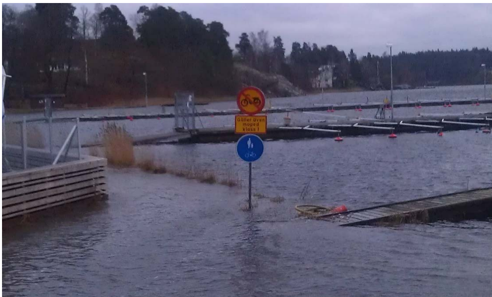
Figur 14, översvämningsskydd vid Nora strand.
