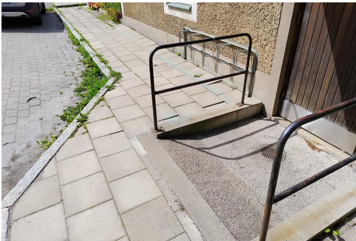
Figur 3-6. Entré vid fastighetens östra sida. En dräneringsbrunn finns i den försänkta delen.
