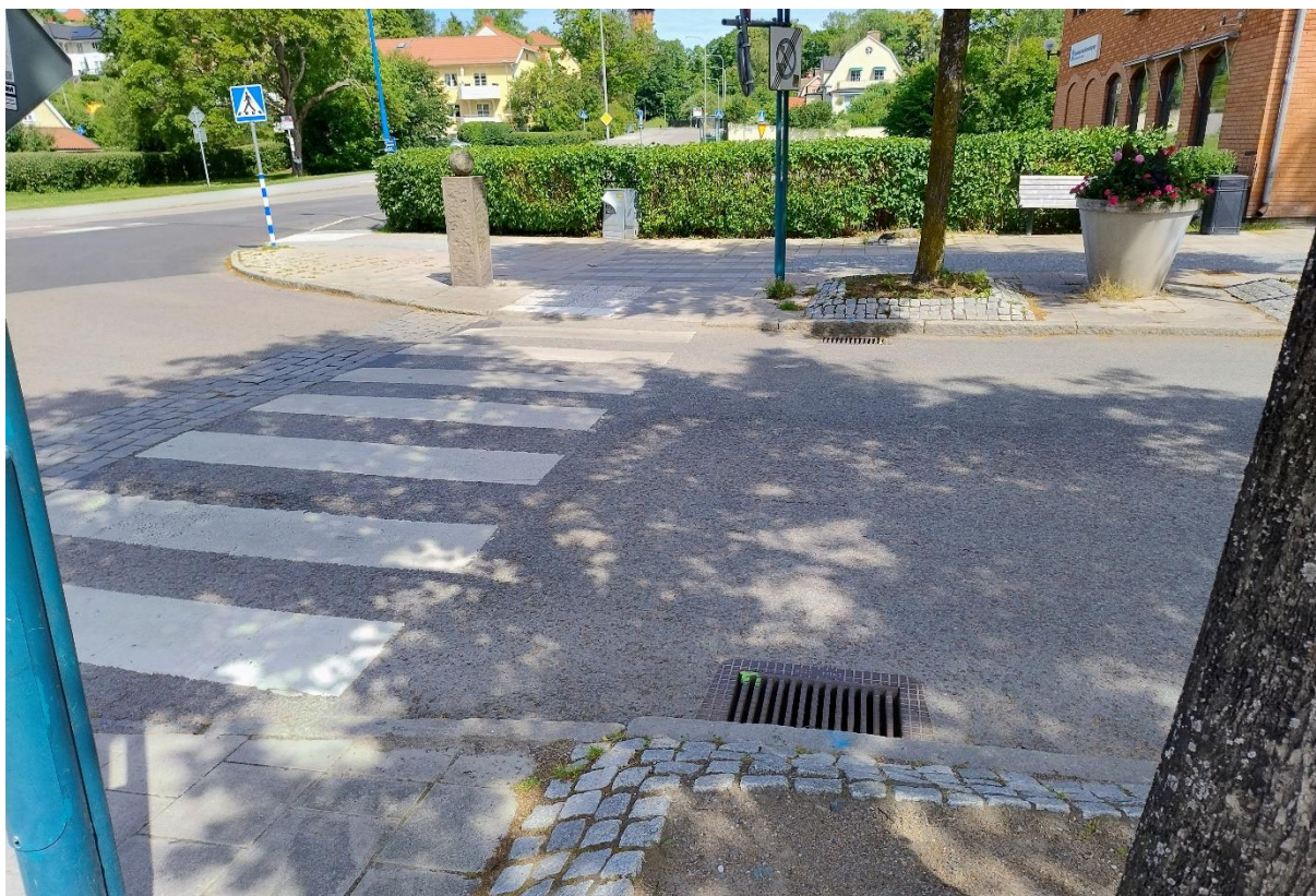
Figur 3-4. Gallerbrunnar längs med Vendevägen.
