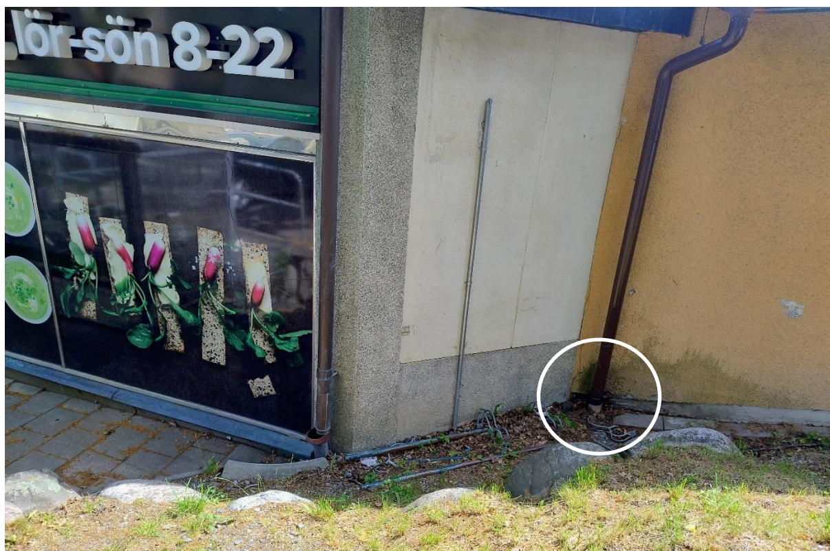
Figur 3-2. Dagvatten avleds till dagvattennätet (vit ovaler) på flera ställen längs med fasaden.
