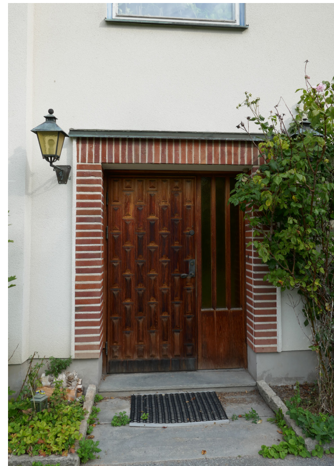
Entrén till Svärdet 14 som markerats med en omfattning i tegel. Notera avrinningen i koppar och den ursprungliga belysningsarmaturen. Sidofönstret vid entrédörren är en typisk signatur för arkitekten Sixten Magnusson.
