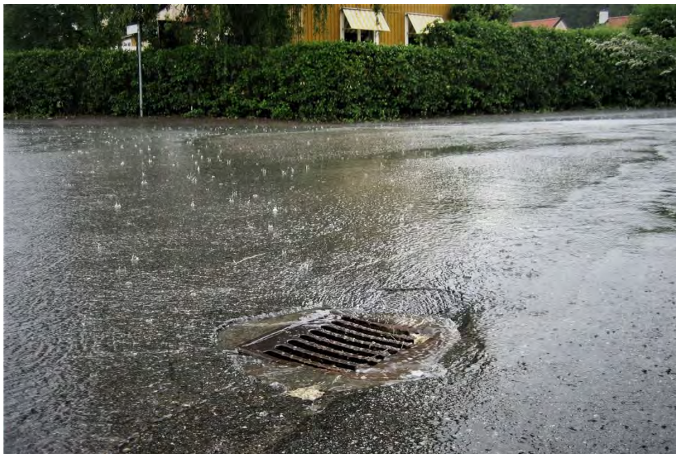
Bild ovan: Regnvatten i dagvattenbrunn.
