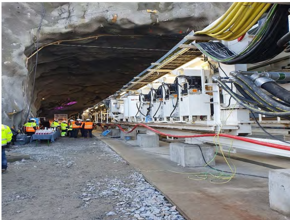
Bild ovan: Kraftledningstunnel.
