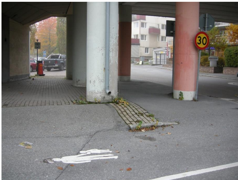
Figur 29 Sättningar skapar otydliga och ojämna ytor
