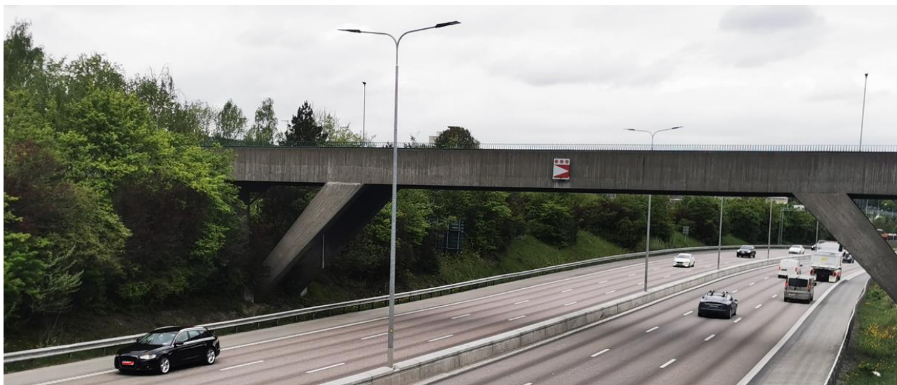
Figur 8 Bockbrons stöd gör att vägreolen troligen har en begränsad fri höjd. Stödet begränsar starkt möjligheterna att skapa en ny påfart.
